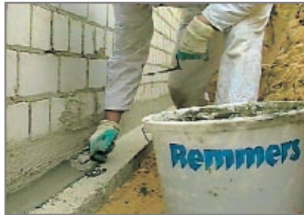
5. Die sog. Hohlkehle wird angelegt: Mit Aida Sperrmörtel wird der Wandaufsatzbereich ausgerundet und damit vorbereitet für die spätere Dickbeschichtung.
