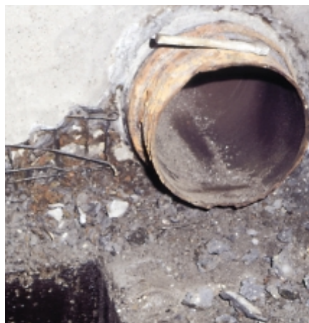
Verrostete Behälterüberläufe und zerstörte Kehlenausrundung.
